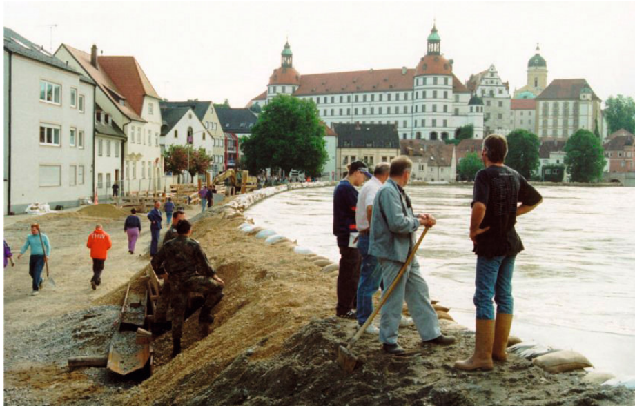
Abbildung 2: Donaukai in Neuburg a.d. Donau beim Pfingsthochwasser 1999 (Foto: WWA Ingolstadt)
